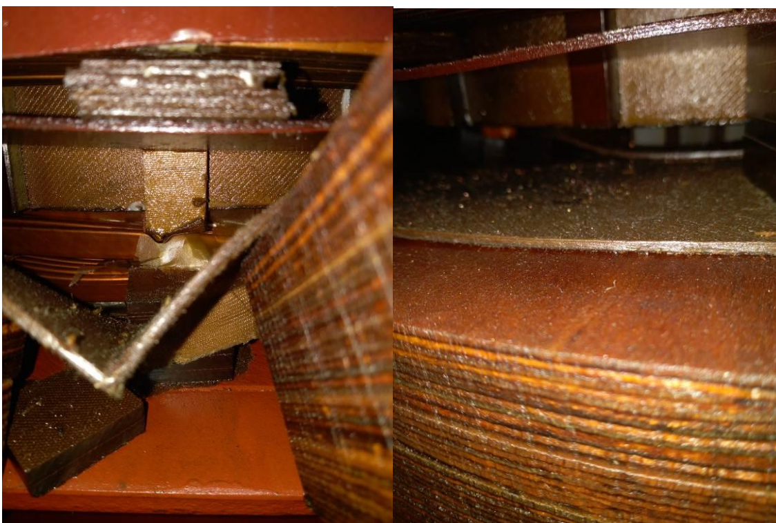
SLIKA 6. FOTOGRAFIJE ZABELEŽENE TOKOM DEFEKTAŽE ENERGETSKOG TRANSFORMATORA TR1 (KRUPAN PLAN).
