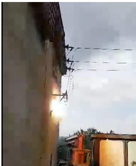
SLIKA 2. PRIMARNI KVAR NA IZLAZNOM PORTALU.
